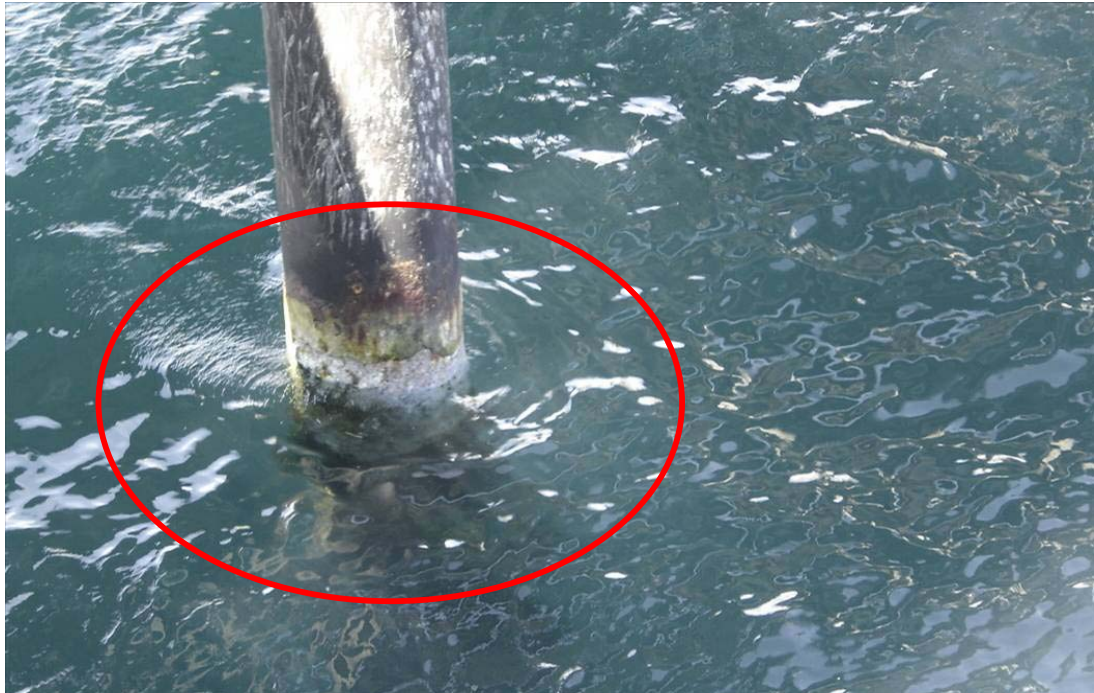
Figura 2: Corrosión Intermareal o en Zona Splash
